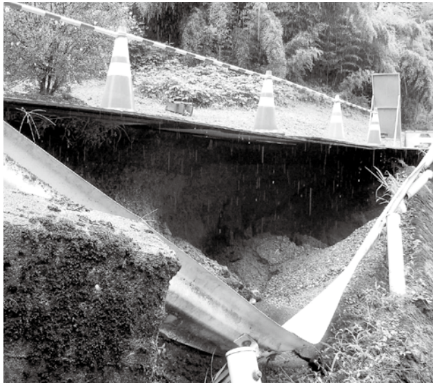
崩落した村道 18 号線 (久木地区)
