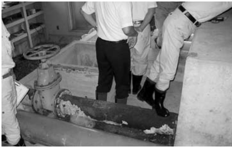
錆ついた送水管
