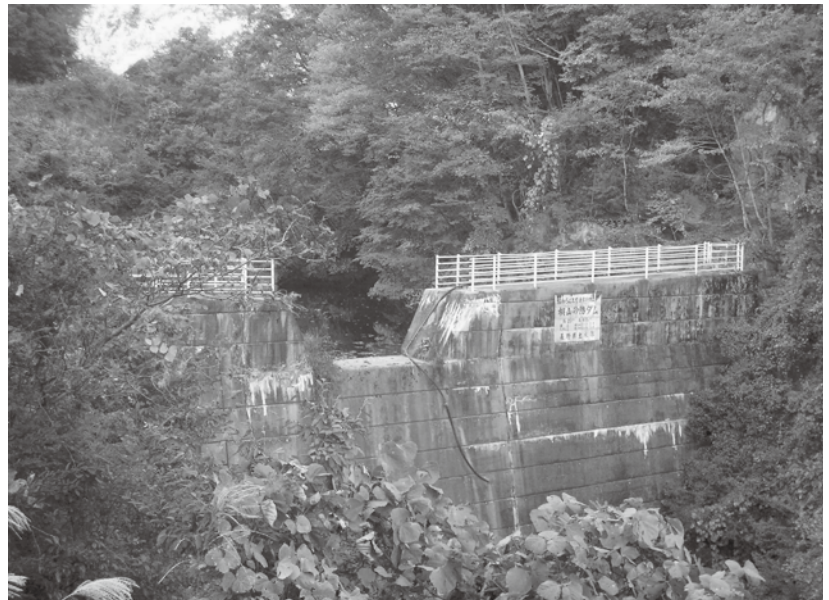
老朽化が見られる桐山砂防ダム
