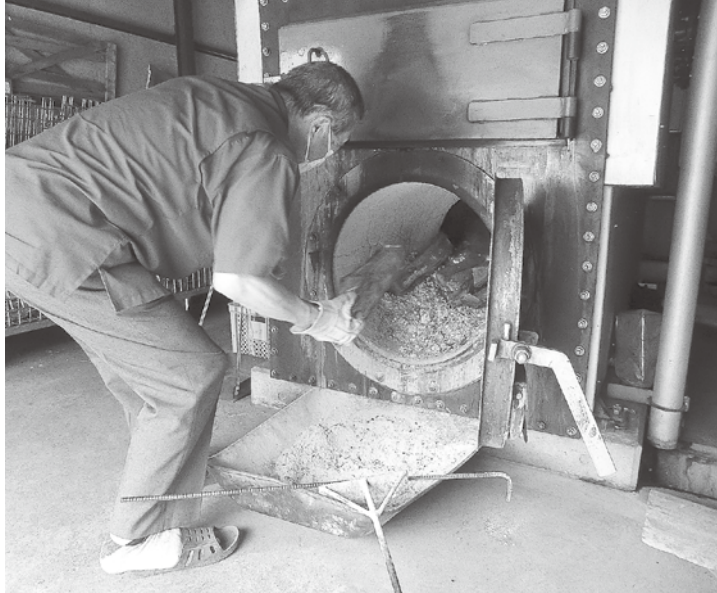
再生可能エネルギーの導入されている小川荘(薪ボイラー)
