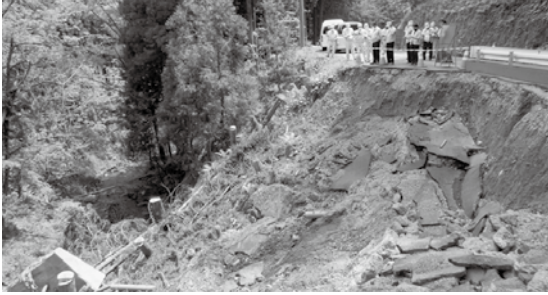
村道3号線の災害現場
