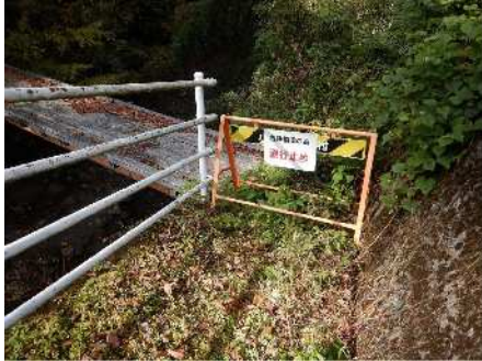
通行止めによる措置
