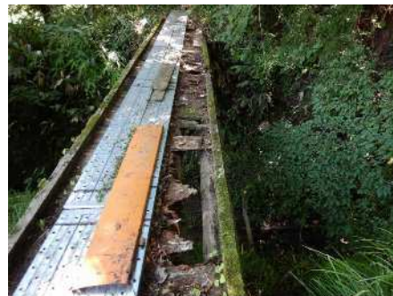
木製床版の腐朽
