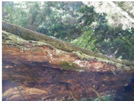
木製桁の腐朽
