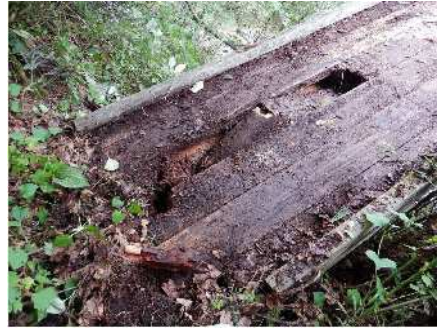
木製床版の腐朽
