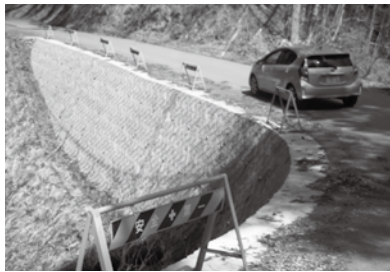
早期にガードレールの設置が必要と思われる災害復旧村道
